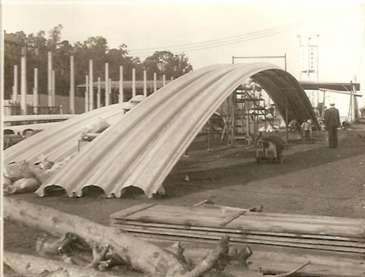
Fotografia 3 - 1º ensaio Telhas arqueadas, com 30,63m de vão livre, antes do início do carregamento.
